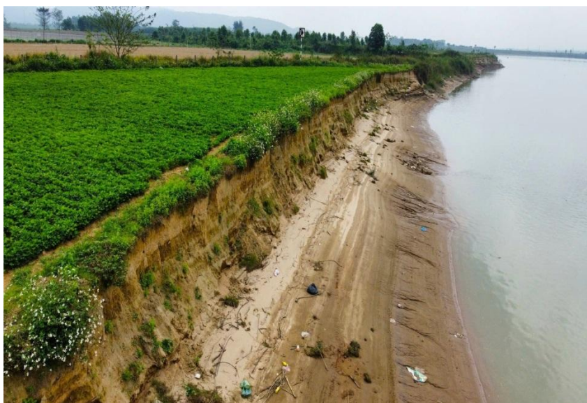
Рисунок 1. Повреждение откоса прибрежной линии
