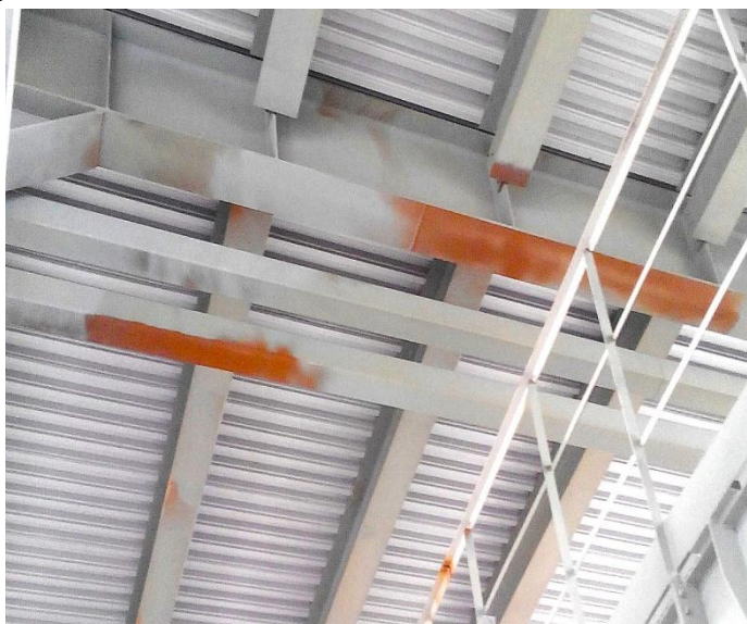
Рис. 2. Ржавчина на металлоконструкции
